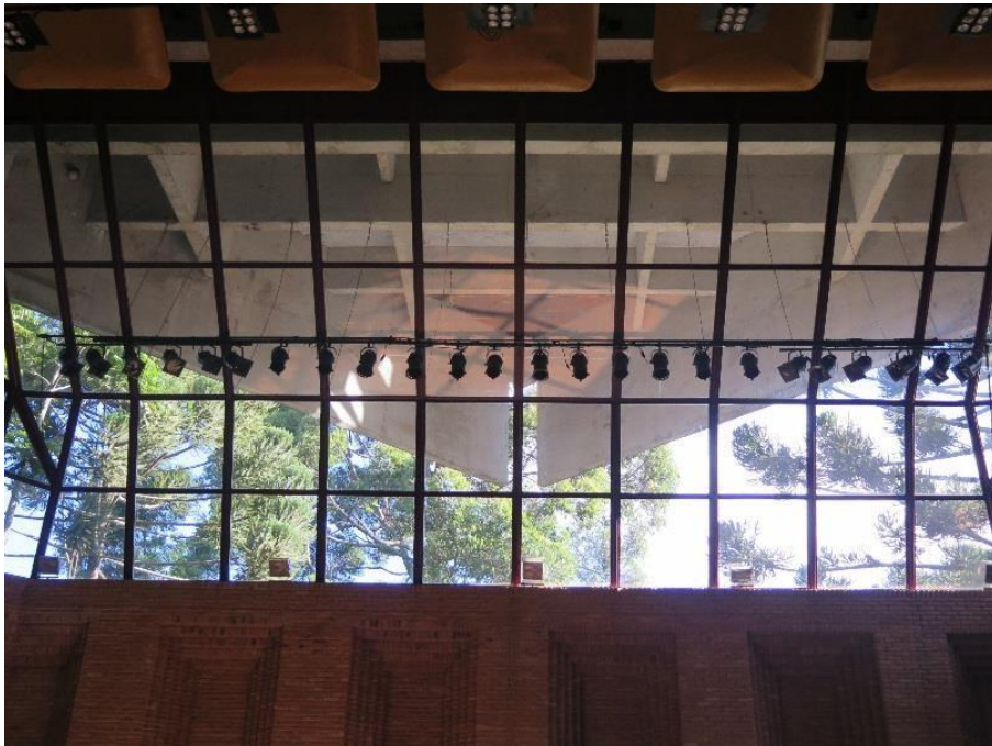
Iluminação - contra: 24 canhões lâmpada par 64 F/5 (1000w)
