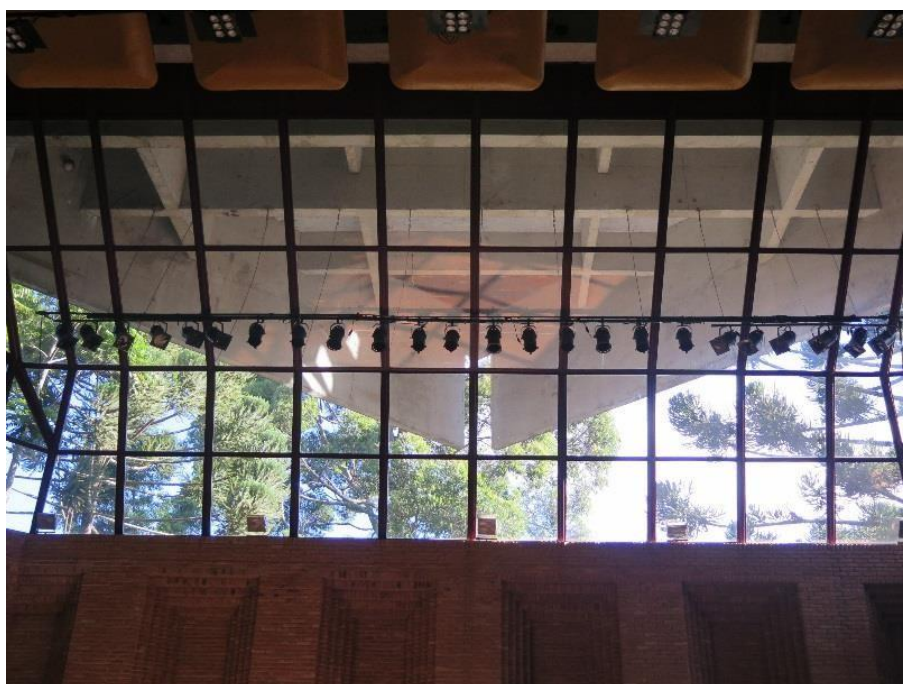
Iluminação - contra: 24 canhões lâmpada par 64 F/5 (1000w)
